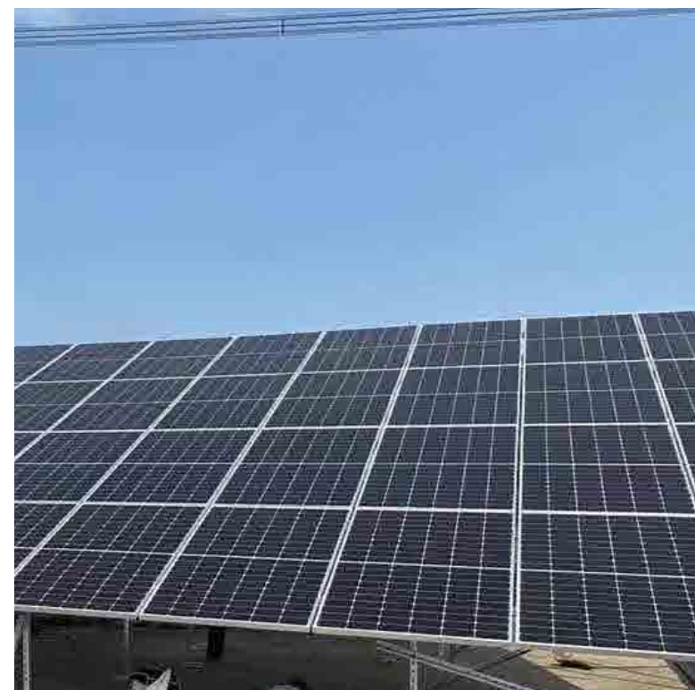
山东 泰安 30KW
